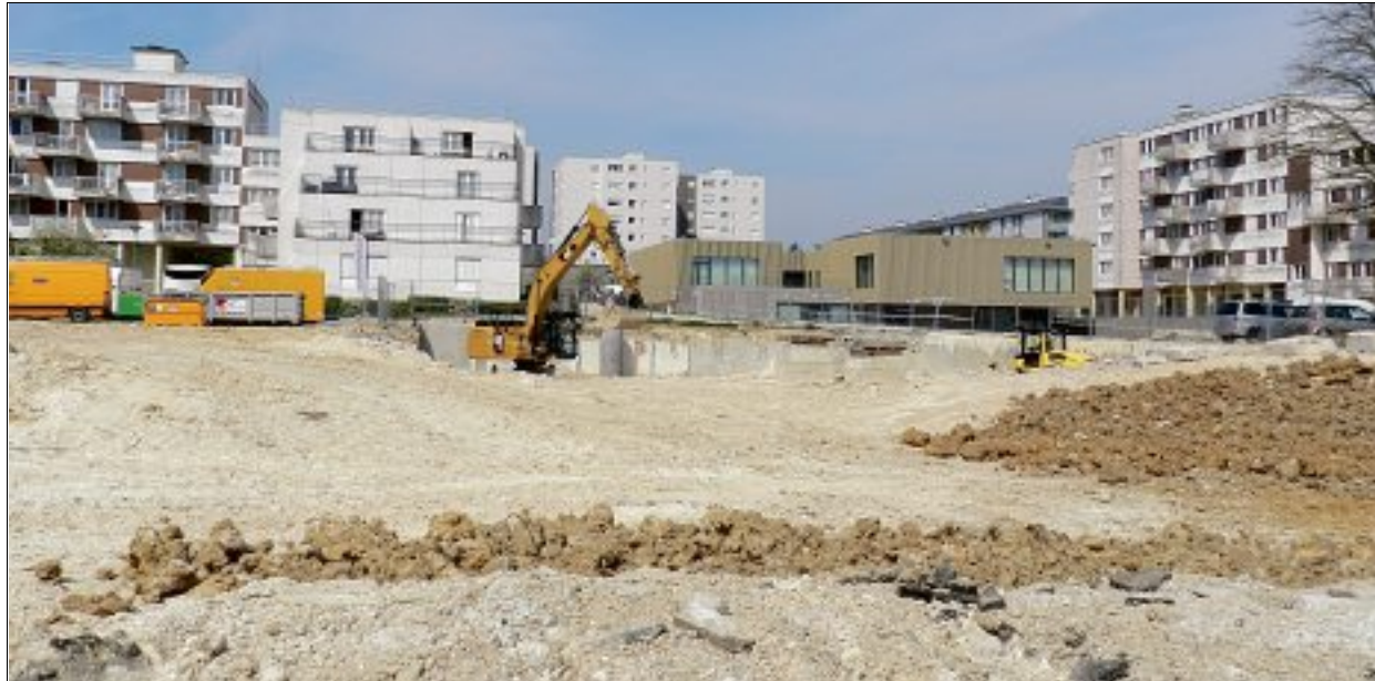
Au cœur du Mont-Saint-Martin, les travaux de remblaiement ont repris avec deux ouvriers et zéro contact.
